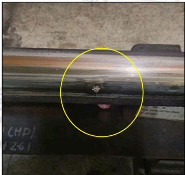
Figura 35 Desprendimiento de material en zonas de unión con soldadura
