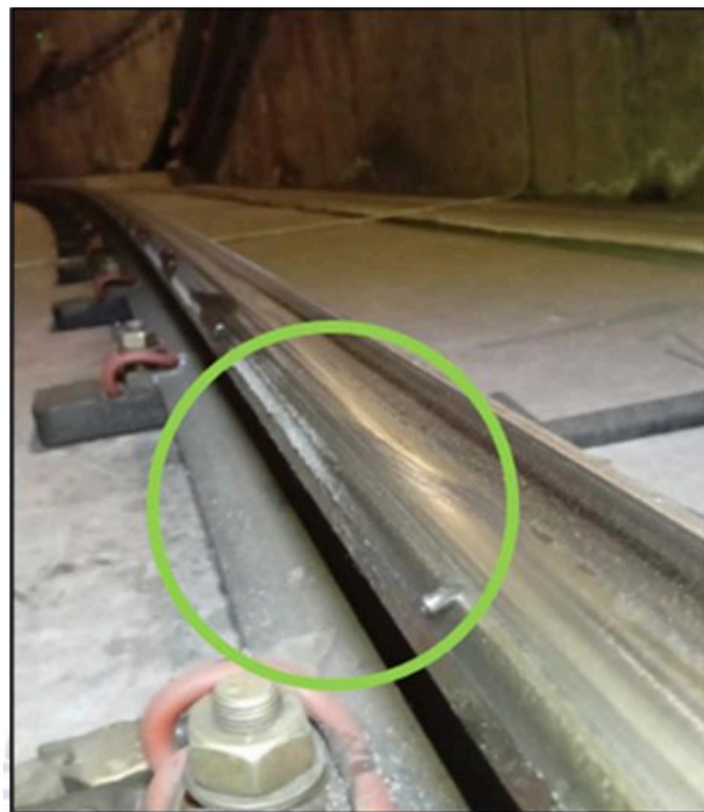
Figura 31 Desgaste de riel en cara activa PK 9+572
