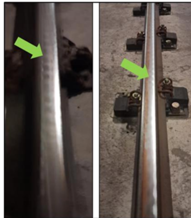
Figura 38 Desgaste ondulatorio en rieles
