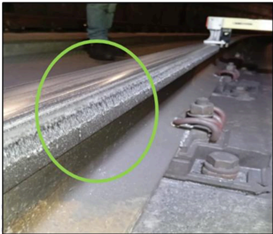
Figura 30 Desgaste de riel en cara activa PK 9+560
