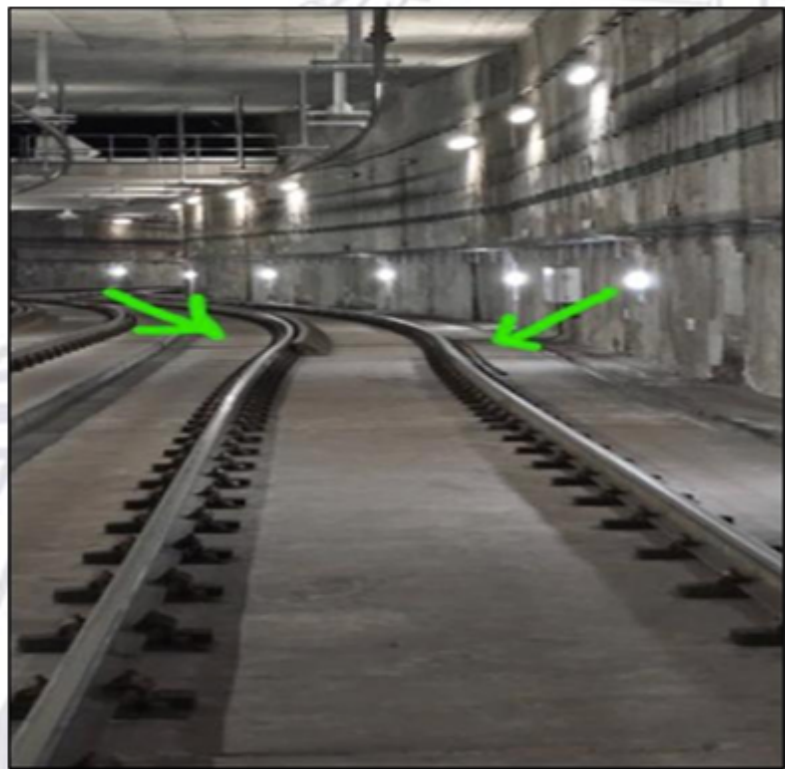
Figura 33 Defecto de alineación o pandeo PK 9+680
