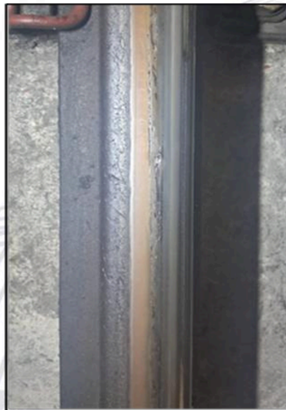
Figura 34 Defecto de rayones en riel y desprendimiento de material
